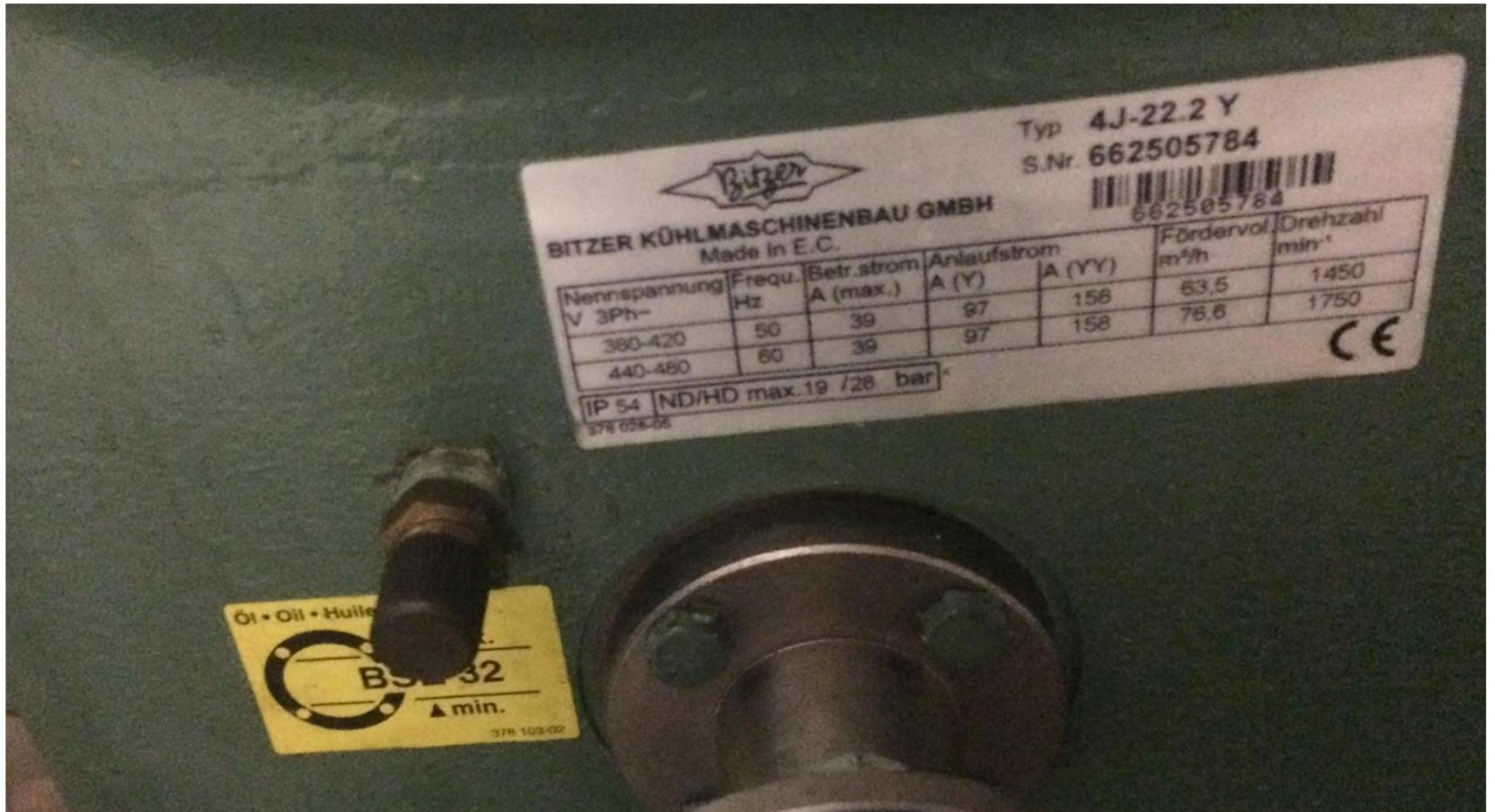
Informatie installatie in de machinekamer: 1 stuks van onderstaande compressor
