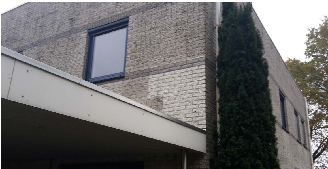
Foto 1. Sterk vervuilde/aangetaste gevels met (boven de veranda) een niet geslaagde proefreiniging
