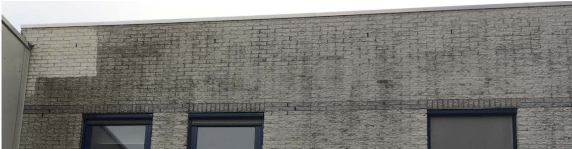
Foto 2. Sterk vervuilde/aangetaste achtergevel met (links boven) een niet geslaagde proefreiniging
